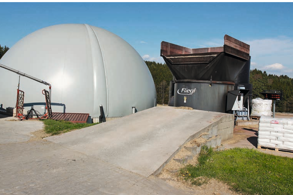
◁ In der flexiblen Biogasanlage vergärt Falter u.a. Klee gras, auch von anderen Betrieben.
