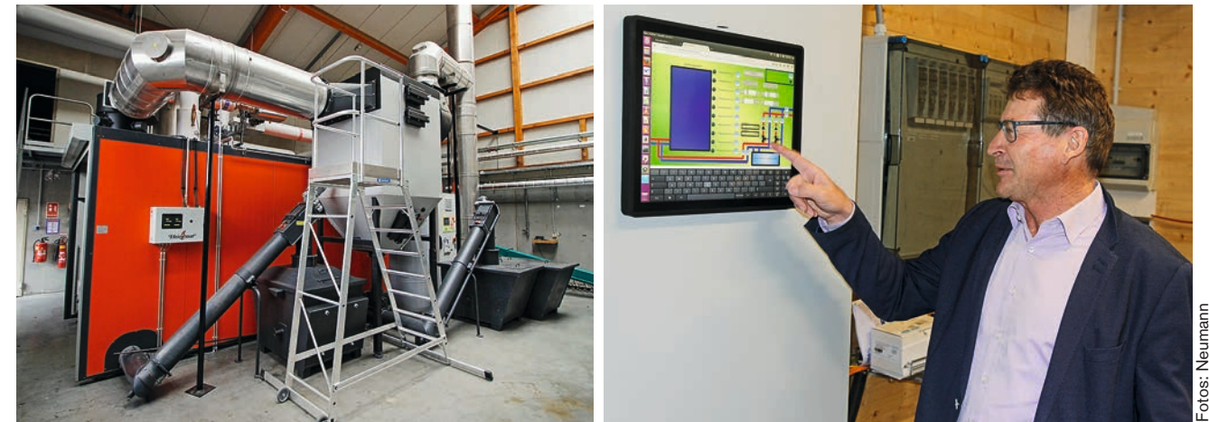
△ Der Hackschnitzelkessel mit 1 MW (links) wird mit den Holzresten aus der Hallenproduktion versorgt. Die gesamte Energieproduktion überwacht Geschäftsführer Rolf Hörmann mithilfe eines Energiemanagementsystems, das die Produktion von Strom und Wärme kombiniert.
