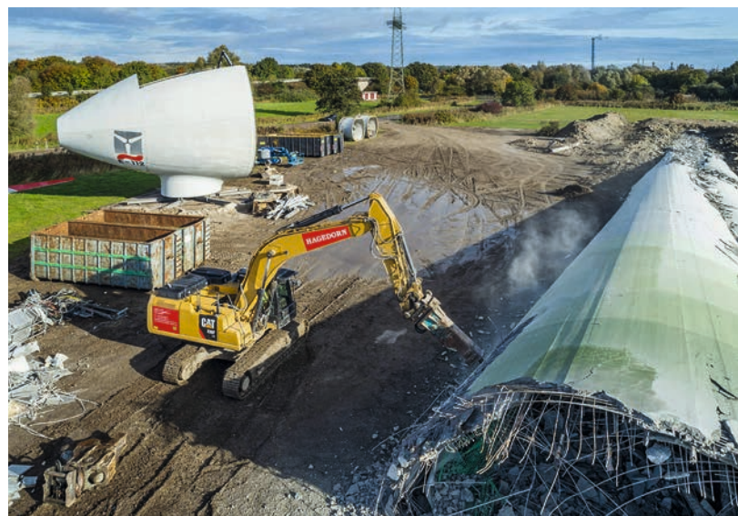
△ Abbruch einer Windenergieanlage: Nach Betriebsende oder für den Ersatz gegen modernere Anlagen (Repowering) müssen ältere Anlagen zurückgebaut werden.
