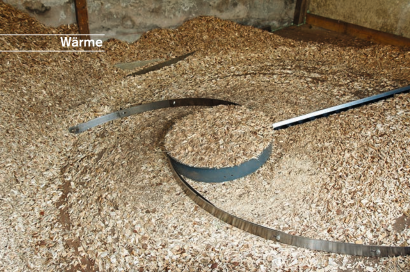
◁ Der Blick in den neuen Hackschnitzelbunker, von wo aus der Brennstoff in die Zuführschnecke des Kessels gelangt.
