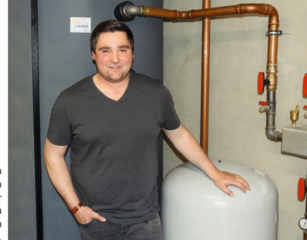
▷ Der Hackschnitzelkessel mit 75 kW steht in einem neu errichteten Heizhaus.
